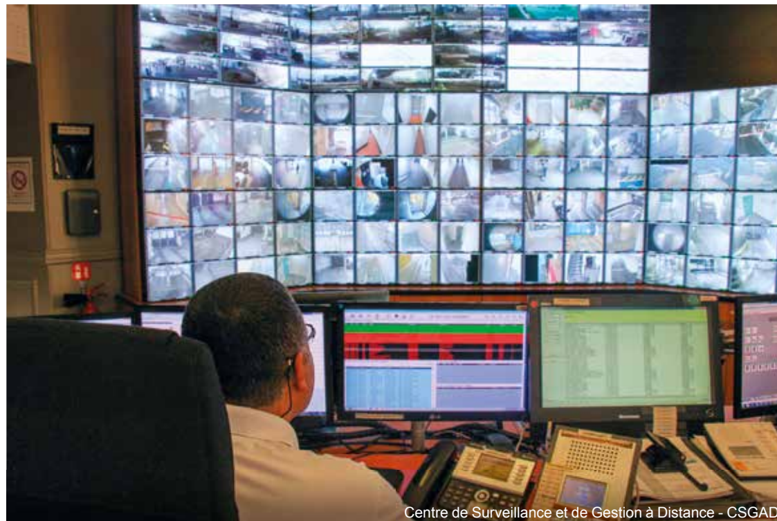
Centre de Surveillance et de Gestion à Distance - CSGAD
