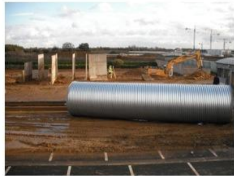
Cuve de rétention de l'eau de pluie
